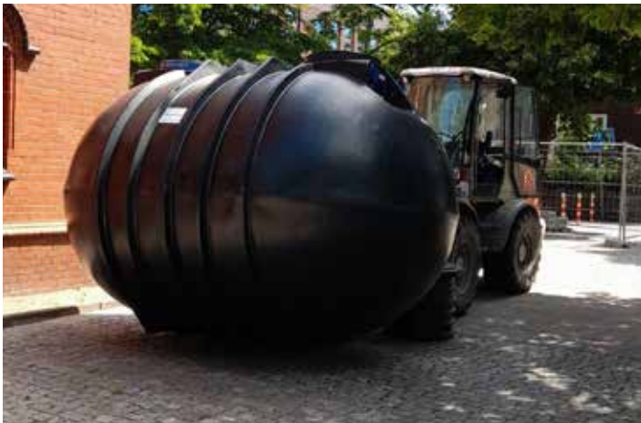
Einer von mehreren Regentanks
